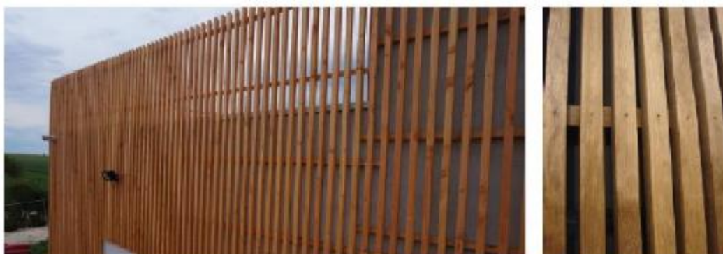
Figure 22 : Exemple de bardage bois sur un poste de livraison
